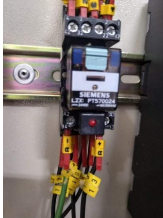
Figura 32. Relé SIEMENS, Fuente: Imagen de fuente propia.
