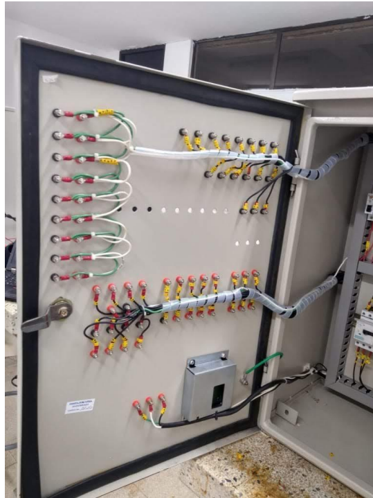
Figura 23. Gabinete de control Fuente: Imagen de fuente propia
