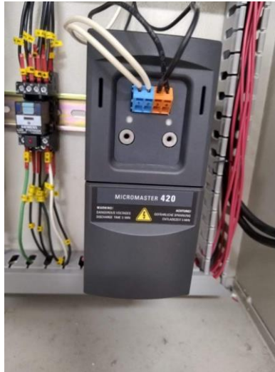
Figura 26. Variador de velocidad, Fuente: Imagen de fuente propia.
