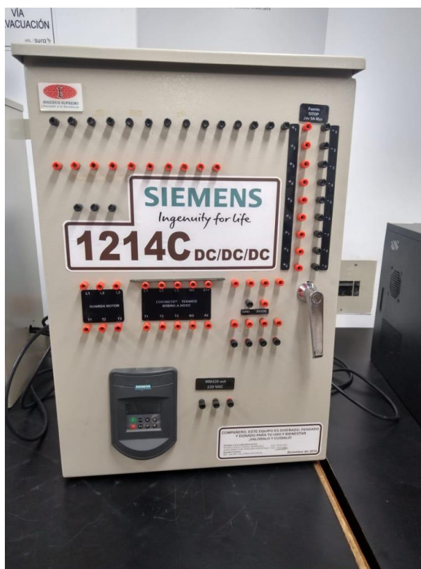
Figura 18. Banco de control por fuera. Fuente: Imagen de fuente propia
